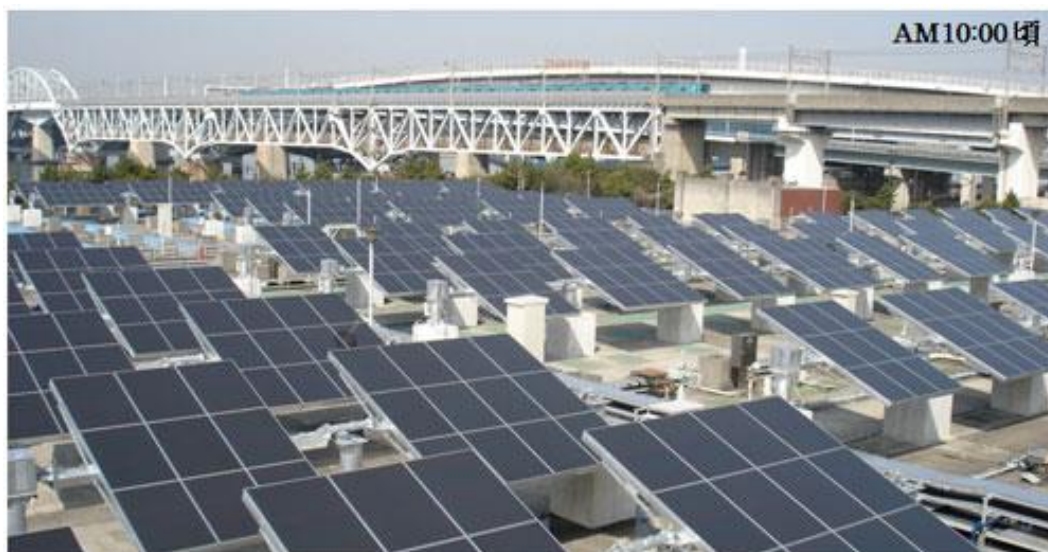
図 13. 葛西水再生センター上部利用（出典：東京都水道局平成 22 年 4 月 8 日報道資料）
