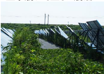
放置されたパネルの現況
