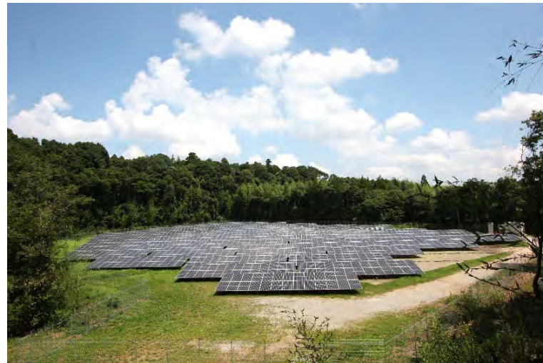
オフサイトコーポレートPPA用太陽光発電システム (千葉若葉太陽光発電所)
