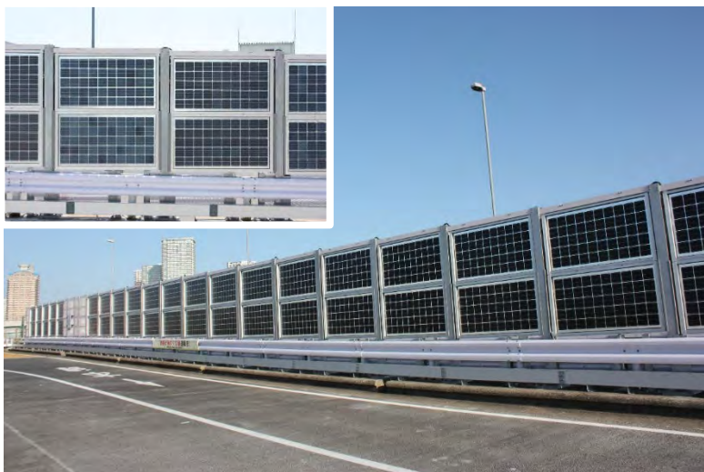
遮音壁型太陽光発電システム (再生可能エネルギーを活用した道路インフラのエネルギープラットフォームの構築)
