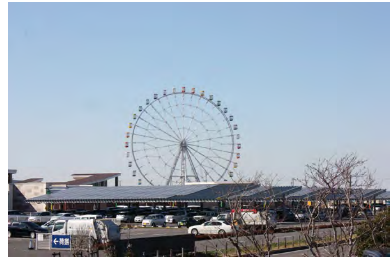
駐車場用太陽光発電システム (三井アウトレットパーク木更津駐車場太陽光発電所)
