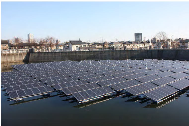
調整池水上設置型太陽光発電システム (フロートソーラー所沢太陽光発電設備)
