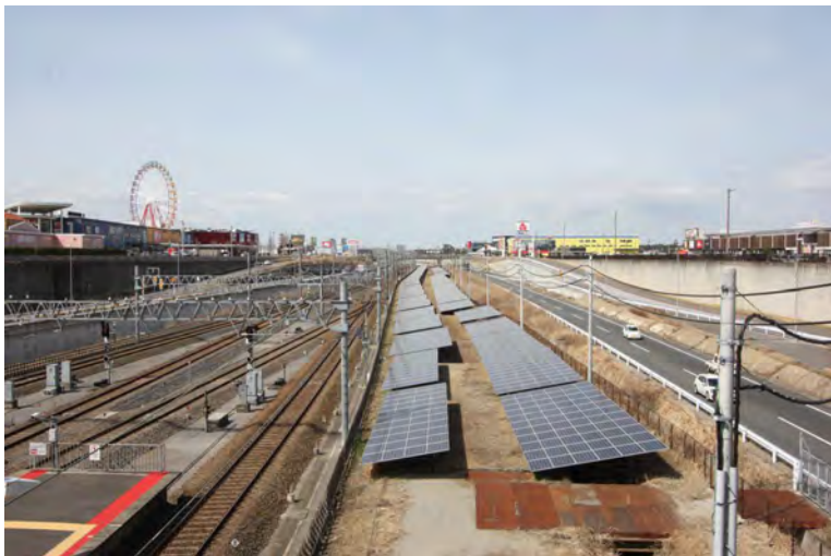
地上設置型太陽光発電システム (SGET千葉ニュータウンメガソーラー発電所 (北総電鉄北総線沿線約10km) )
